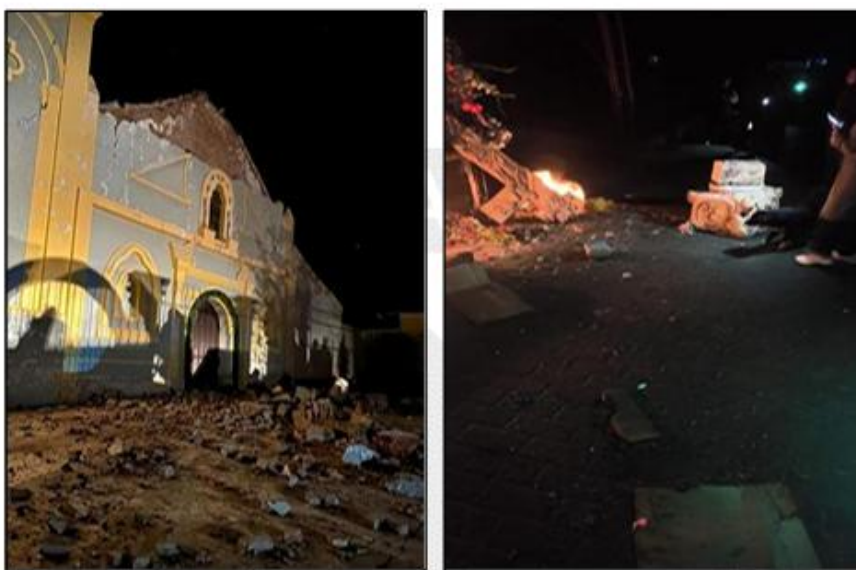
Colapso del Cani Cruz de la Iglesia y Restos del Antiguo Convento de "Santiago de León"
